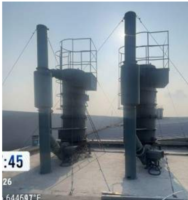
Hình 3.12: HTXL bụi từ công đoạn sàng lọc, tạo viên, ép vòng của dây chuyền sản xuất pin kẽm mangan (pin khô, loại carbon) đã lắp đặt tại nhà
